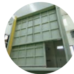
風雨試驗設備
